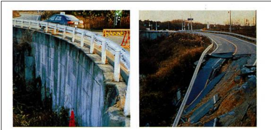
Figure 1-13 : rupture d'un talus renforcé
