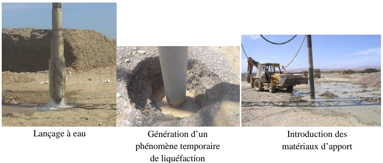
Fig 1.7 Etapes de réalisation d'une colonne ballastée par voie humide [Benchelha et Saidi] (Cas des ouvrages d'art de la rocade méditerranéenne de Nador)
