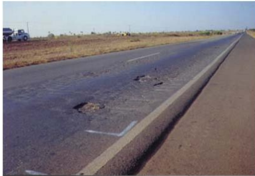
Endommagements sur une chaussée conventionnelle
