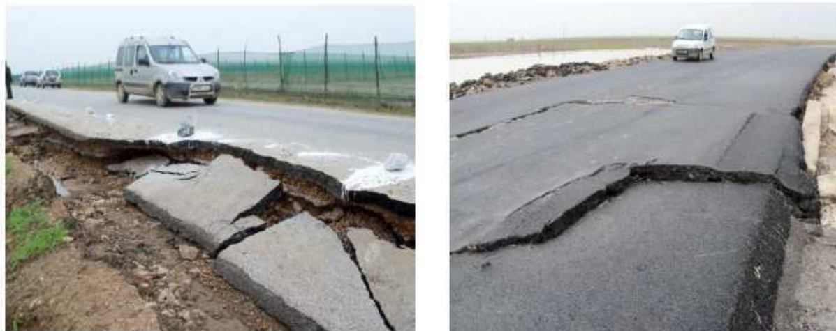
Figure II-11 dégradation de RN1 [CNER en Maroc 2010]
