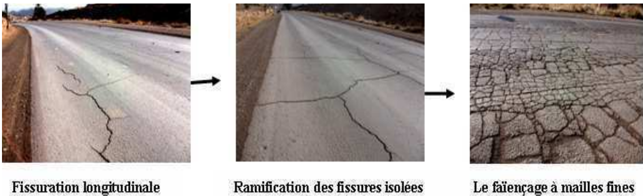
Figure (II-7) Dégradation de la chaussée de RN3 entre BATNA-BISKRA (Section de MOULYA PK248+500 à PK 256+723)
