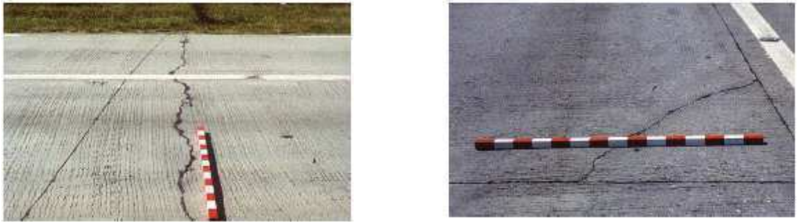
Figure I-9 Fissures transversales et en coins [J M Balay et H Odéon]
