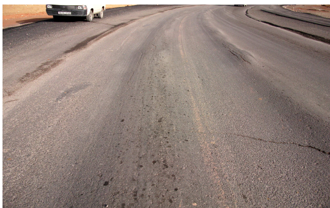
Figure (I-8) L'orniérage de la chaussée de la RN 3 sections MOULYA
