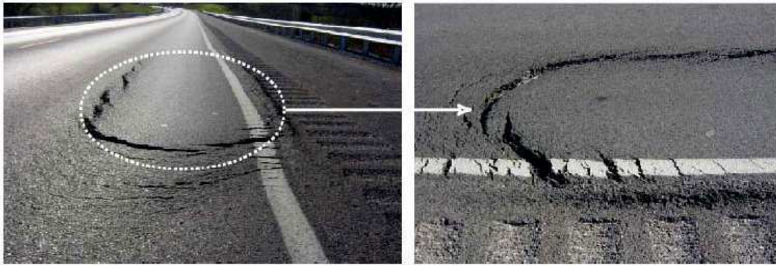
Figure II-10. Dégradation due à un défaut de collage à l'interface [M DIAK 2007]
