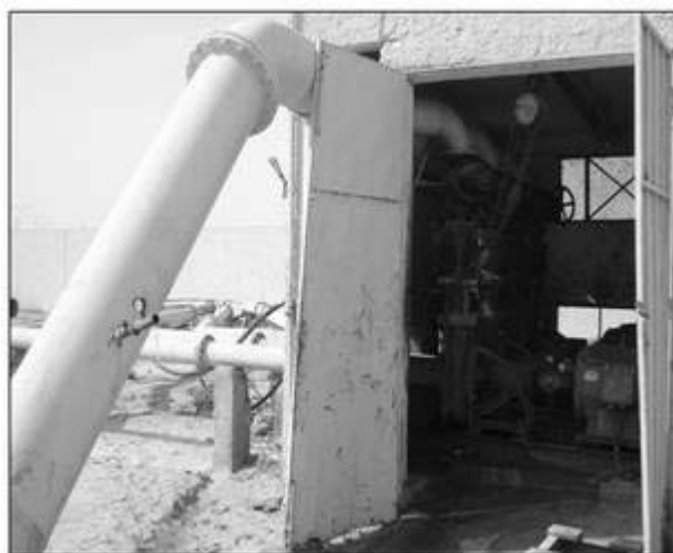
Fig.5.3- La station de pompage des eaux de drainage horizontal
