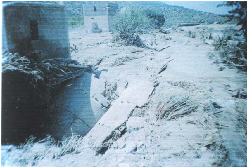
Affaissement et fissuration de la route (Tighanimine)
