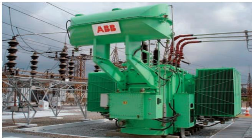
Fig. A.I.1 : Transformateur ABB de 25 MVA, 138 kV, rempli avec l'huile ester naturel Biotemp
