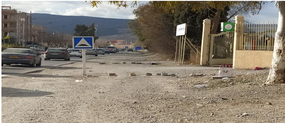
Figure III-10. Etat de la piste du bord du tronçon étudié.
