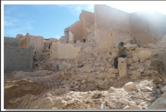
صورة رقم 08 : تردي الإطار المبني داخل حي بني ابراهيم
