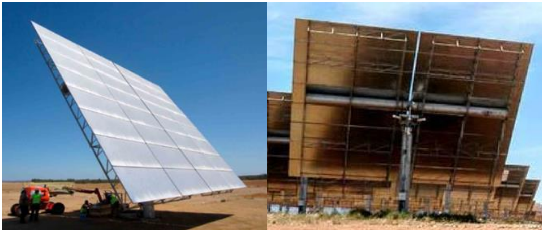
Figure 1.16. Gauche : héliostat ASUP 140 (Abengoa) ; Droite : vue de face, Vue Arrière [3336,3740].
