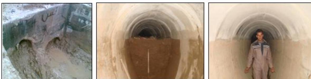
Figure 95. Le problème des boues au niveau de collecteur des pluies pluvial de Keshida, nécessite un entretien fréquentiel, (source : direction de hydraulique, 2014).
