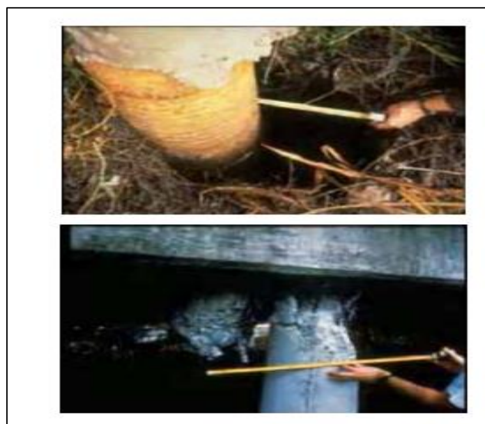
Figure 1.8. Effondrement du pont de Struve Slough près de Wastonville et les dommages subis par ses fondations, (Séisme de Loma Prieta 1989).
