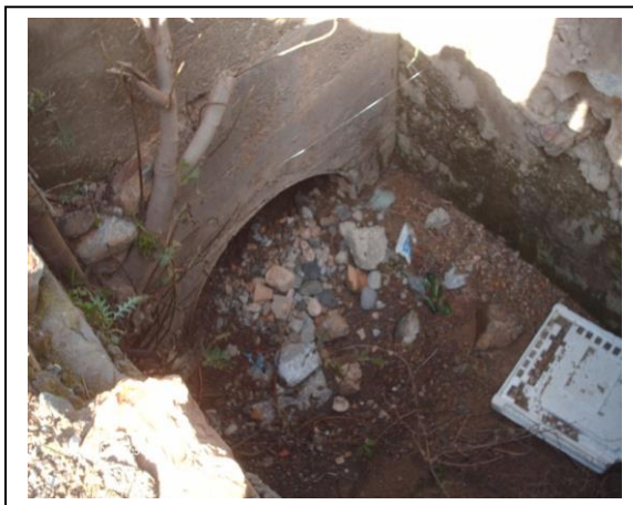
Figure IV-5 : Encombrement et bouchage
