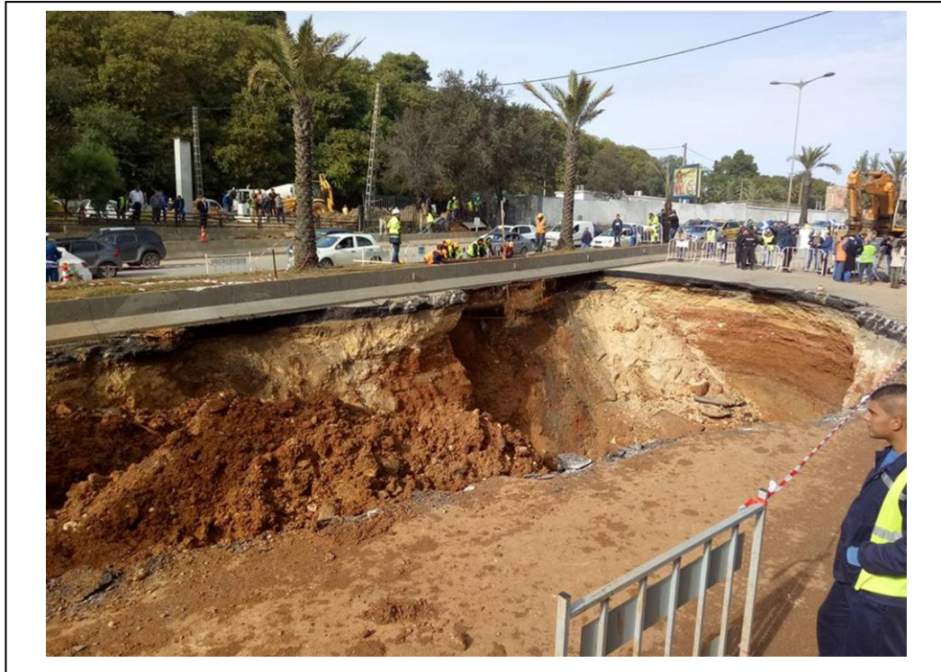
Figure I-4 : Chantier de réhabilitation de l'effondrement d'une voie à Ben Aknoun (Alger)
