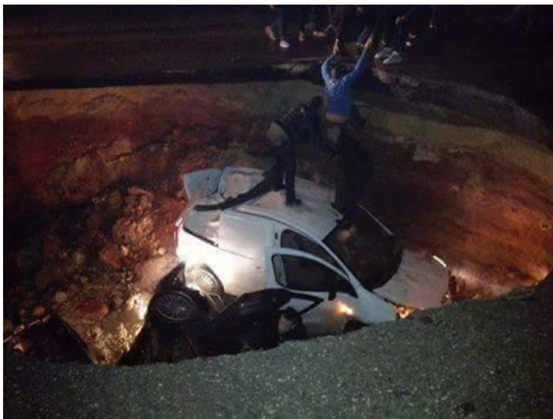
Figure I-3 : Effondrement d'une voie de l'autoroute Ben Aknoun – Zéralda (Alger)
