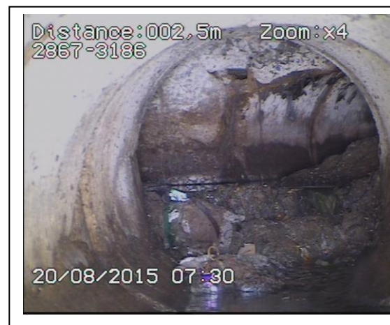
Figure IV-6 : Ecrasement de canalisation
