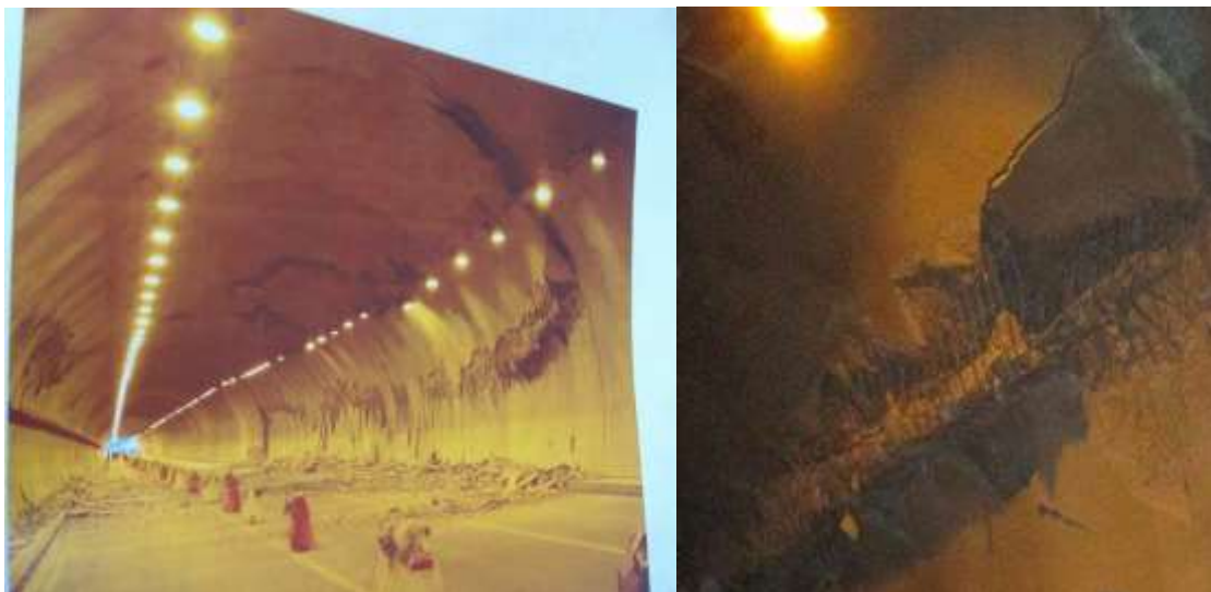
Fig. II.3 : l'état de lieu de l'ouvrage après l'effondrement (L'endommagement de revêtement de tunnel gauche)(document de projet)
