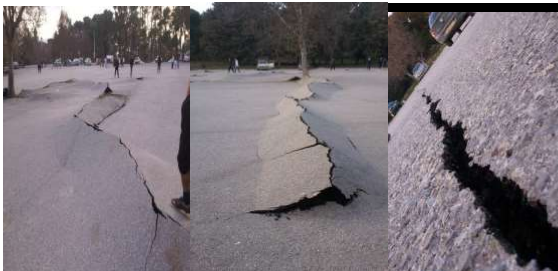
Fig. II.4 : l'état de lieu de l'ouvrage après l'effondrement (Soulèvement de sol au-dessus de tunnel, et destruction de chaussée)(document de projet)
