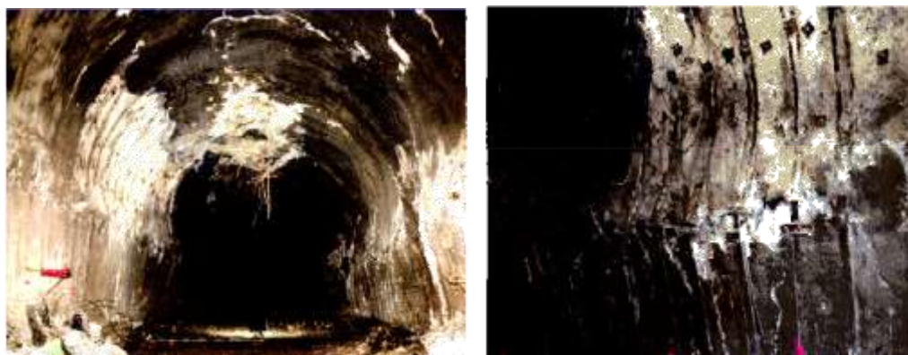
Fig. I.7. Rupture de soutènement du tunnel routier de Tymfristos à cause d'une forte convergence [(Kontogianni, Tzortzis, & Stiros, 2004)]
