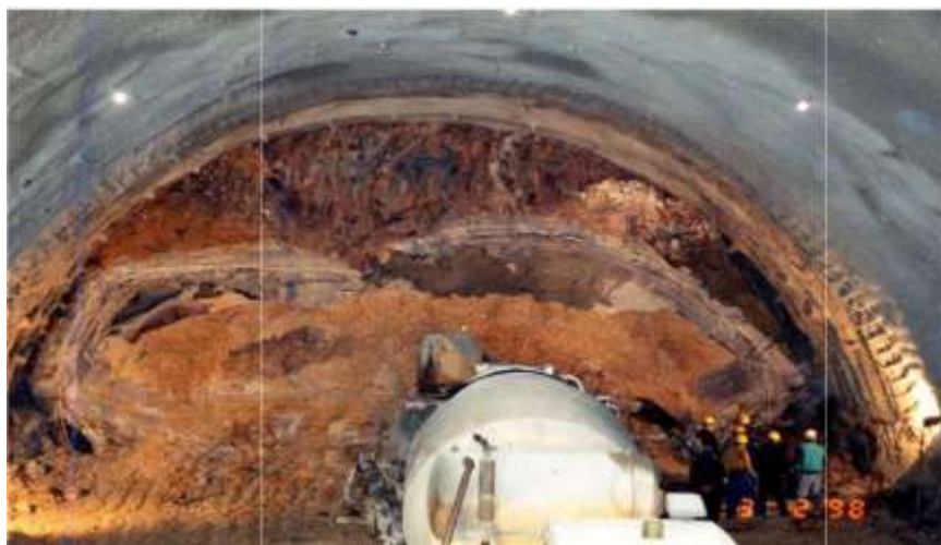
Fig. I.22 : Effondrement du Tunnel de Bolu en Turquie 1999 [(Cité par Sliteen, 2013)].
