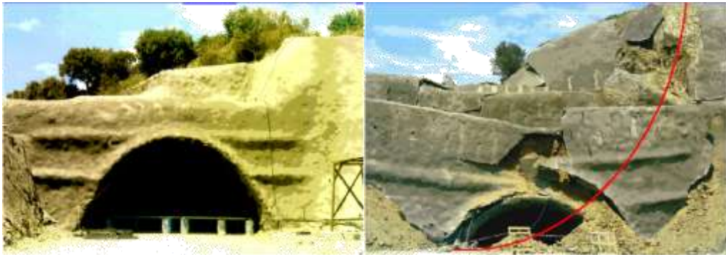
Fig. I.2. Tunnel de Patra avant et après l'effondrement (Grèce, août 1998), [(Patra, 2004)]
