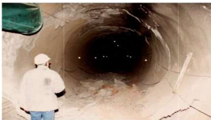
Fig. I.21 : Dégâts occasionnés sur le tunnel pilote du projet du tunnel bi-tubes de Bolu lors du séisme de Düzce – 1999 [(cité par Sliteen, 2013)].
