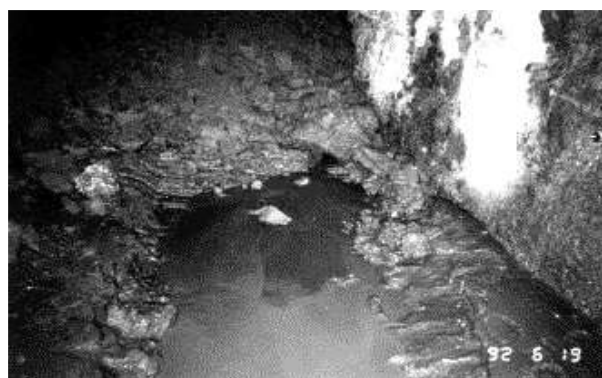
Fig. I.6. Inondation du tunnel de Wushantou, Japon 1992, [(Wang et al , 2001)]
