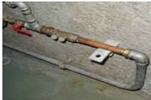
Figure I. 2. Corrosion galvanique d'un coude en acier doux relié à un tuyau en cuivre.
