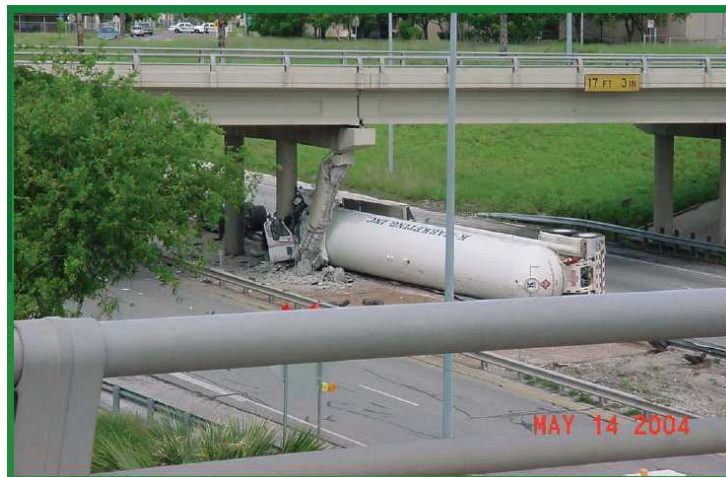
Figure 1.1: Colonnes sévèrement endommagées en raison d'un impact de véhicule
