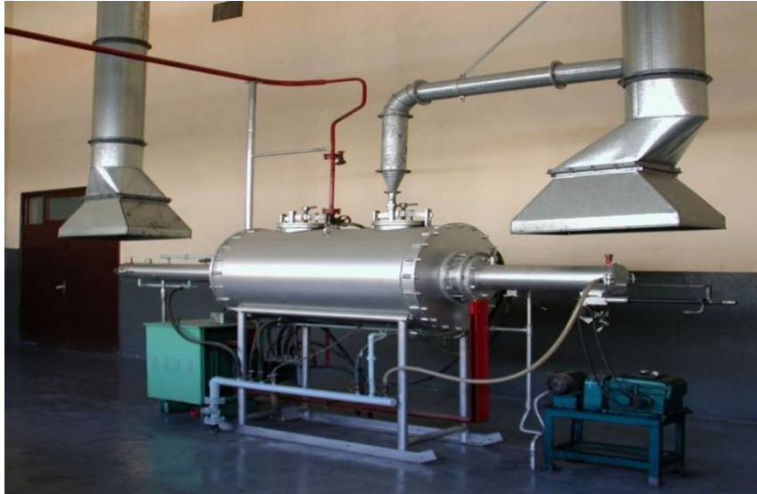
Figure III. 8 : Four à hydrogène
