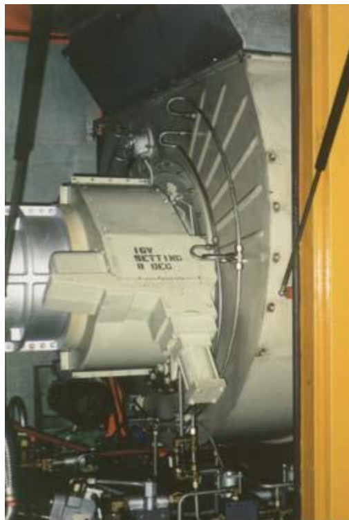
Turbine à gaz – S TEP Achères (78)
