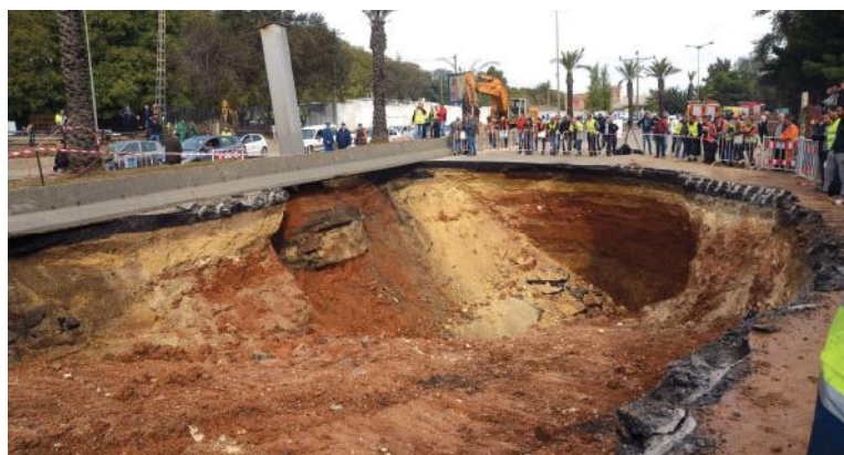
Figure 2.8 effondrement récent à Alger.
