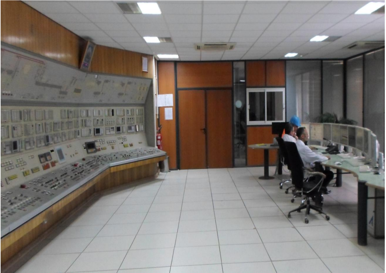
Figure 1.3. Ancien et nouveau système de supervision.
