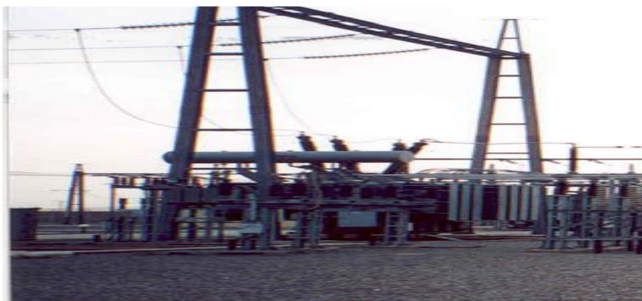
Fig.III.9. Connexion de self côté arrivée de ligne.
