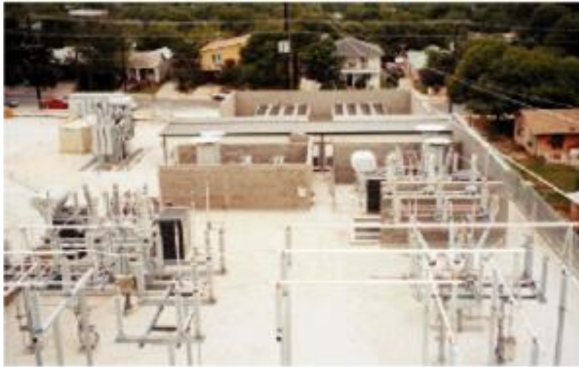
Emplacement d'un STATCOM.
