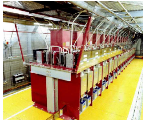
Une phase d'un STATCOM.
