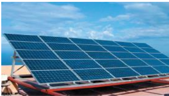
Fig 1.5: Vue d'une installation photovoltaïque [27]. (Photo du Centre de Développement des Energies Renouvelables – CDER, Bouzaréah)
