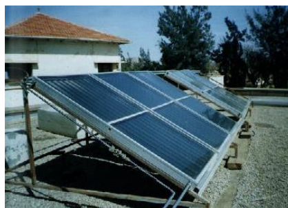
Fig 1.4: Vue d'une installation thermique (chauffe-eau solaire) [25]. (Photo de l'Unité de Recherche - Université de Batna)
